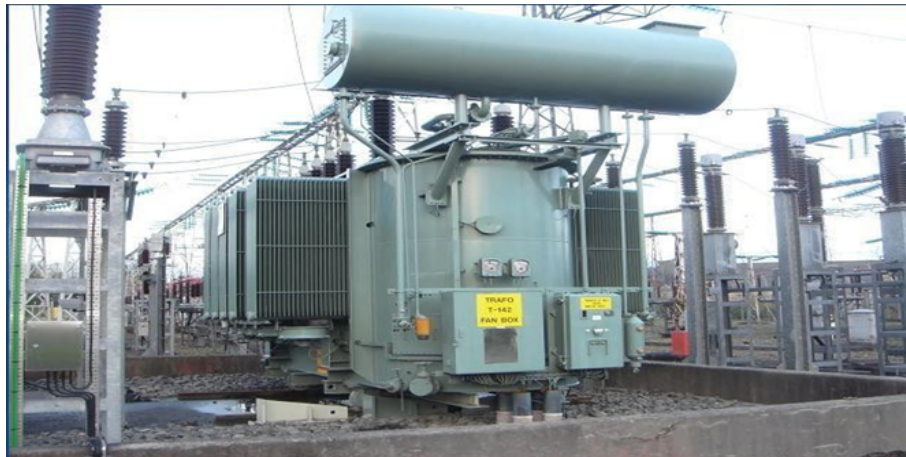
FIGURE 1.7 – : transformateur vue extérieure
