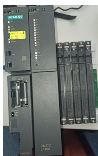
FIGURE II.1: Contrôleur PLC S7 410-5H
