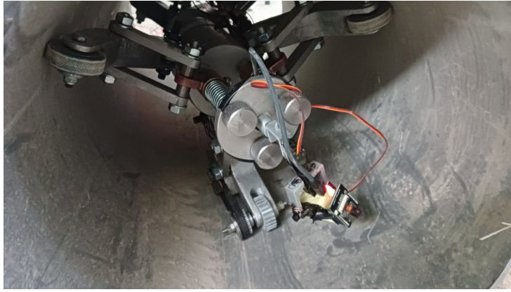
FIG. 3.14 – Le robot dans le pipeline
