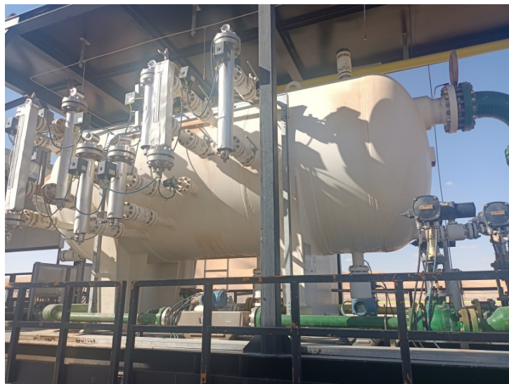
Figure 2.3 : Séparateur de test mobile 71V-1001
