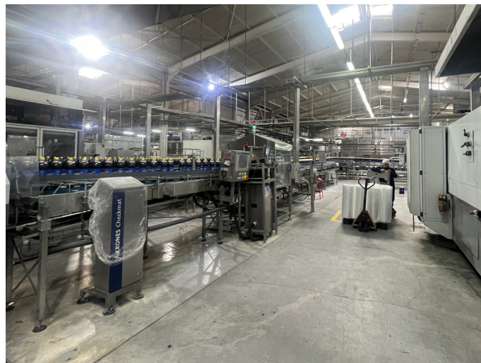
FIG. 2.1 : Lignes de conditionnement de Hamoud Boualem - Boufarik
