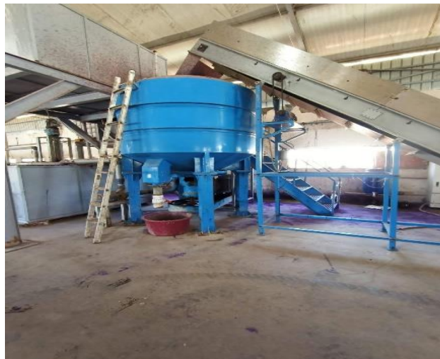
Figure D- 3: Le broyeur SH 2213
