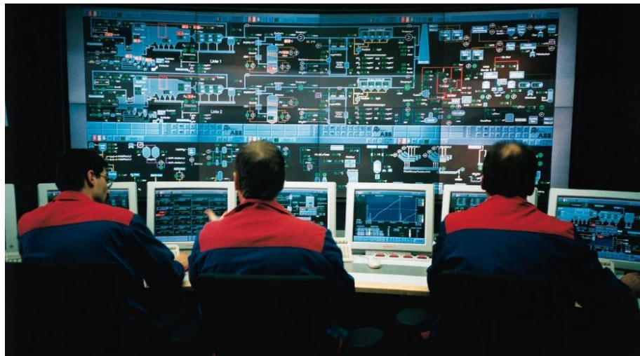
Figure I.1 : Salle de contrôle DCS
